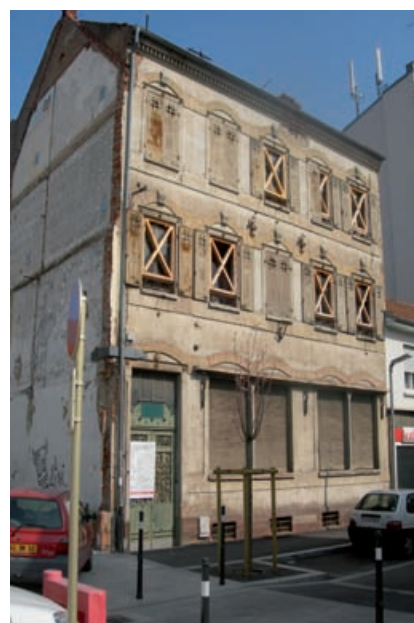
Franklin – Immeuble condamné rue du Gaz
